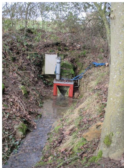
Equipement de l'exutoire du lysimètre géant de l'Orgeval
